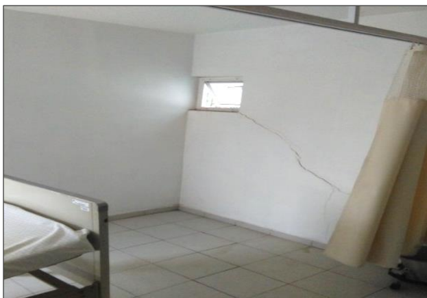
Imagen de las condiciones en que se encuentra la infraestructura del Centro de Salud de “Las Lomas”.
