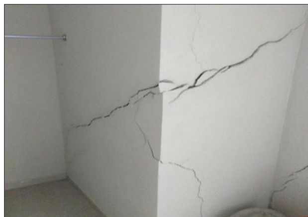
Se aprecia el deterioro progresivo de parte de la estructura del Centro de Salud..
