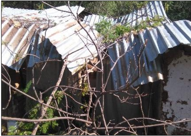
Destrozos causados por la caída de un árbol sobre una vivienda de nuestro municipio.
